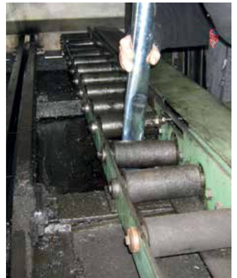
Aspiration de boues sur rectifieuses
